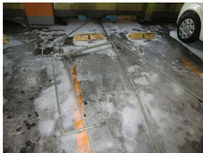
泡流出事故の例
