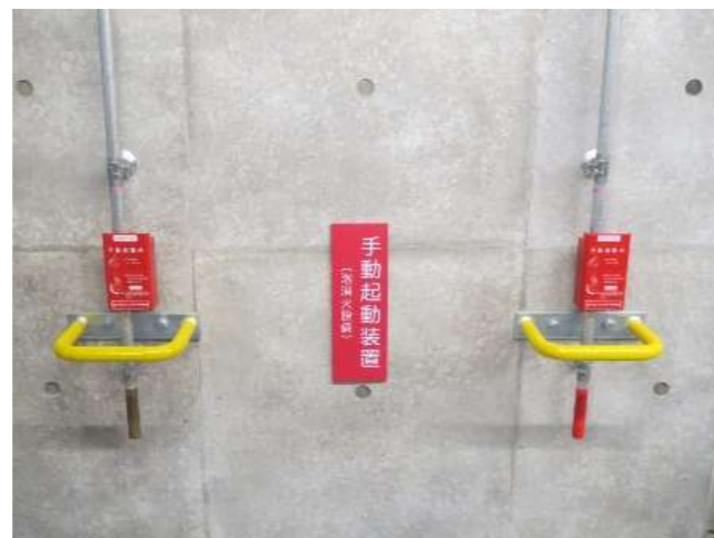
手動起動装置に保護ガードを設置
