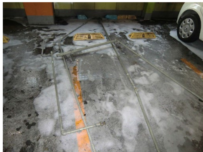
泡流出事故の例
