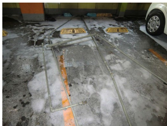
泡流出事故の例
